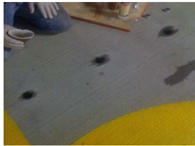
地坪膨拱處理
