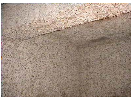
污水槽遭嚴重侵蝕而骨材外露
