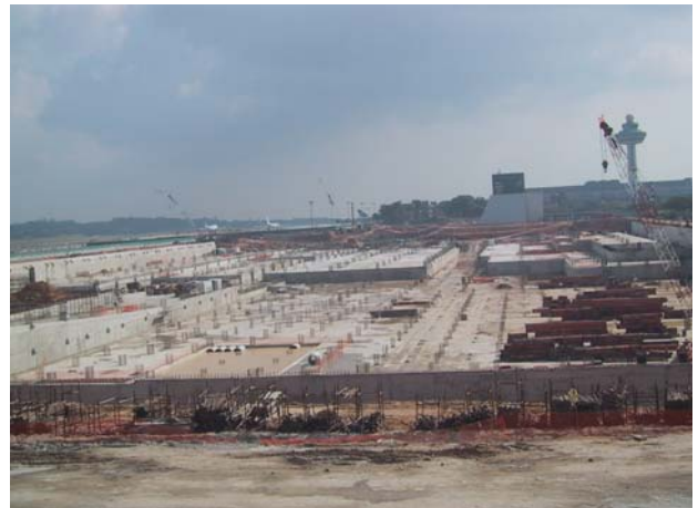
新加坡樟宜機場 3 號航站大樓擋土牆的混凝土中 添加克漏牆 ® 803 軀體防水添加劑
