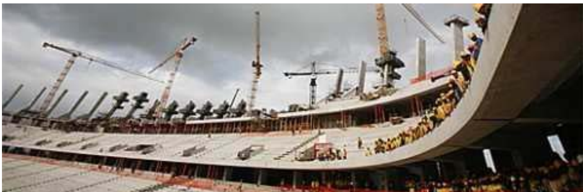
南非 2010 年世界杯運動場新建工程於混凝土中添加克漏牆®軀體防水添加劑 803
