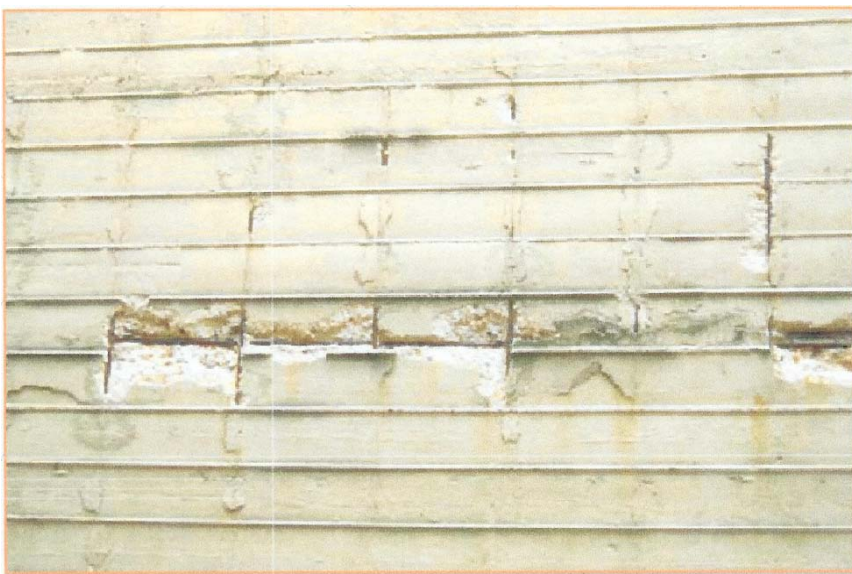
圖 2：一般採光牆損壞後所顯現的剝落現象與暴露的鏽蝕強化鋼筋
