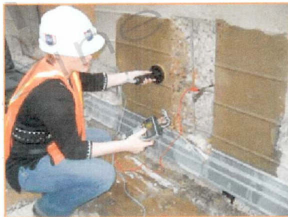
圖 8：以腐蝕速率偵測器偵測遭腐蝕損壞處的鄰牆，其未修繕下的腐蝕活動情況。
